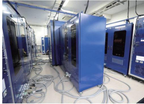
配電系統シミュレーターでは数kmの配電網を再現できる。現実で起こり得る現象をこの装置を使って実験している。
